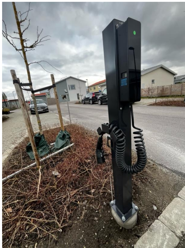
Figur 4 Foto av den installerade laddningsstolpen framför respektive parkeringsplats
