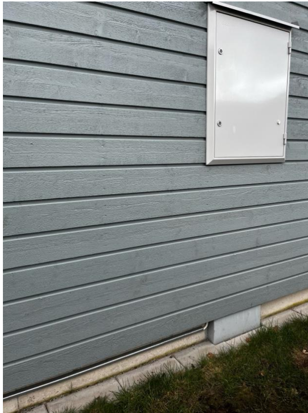
Figur 3 Foto av sidan av envåningshuset med installation av elkablar längs grunden och anslutning till elskåpet
