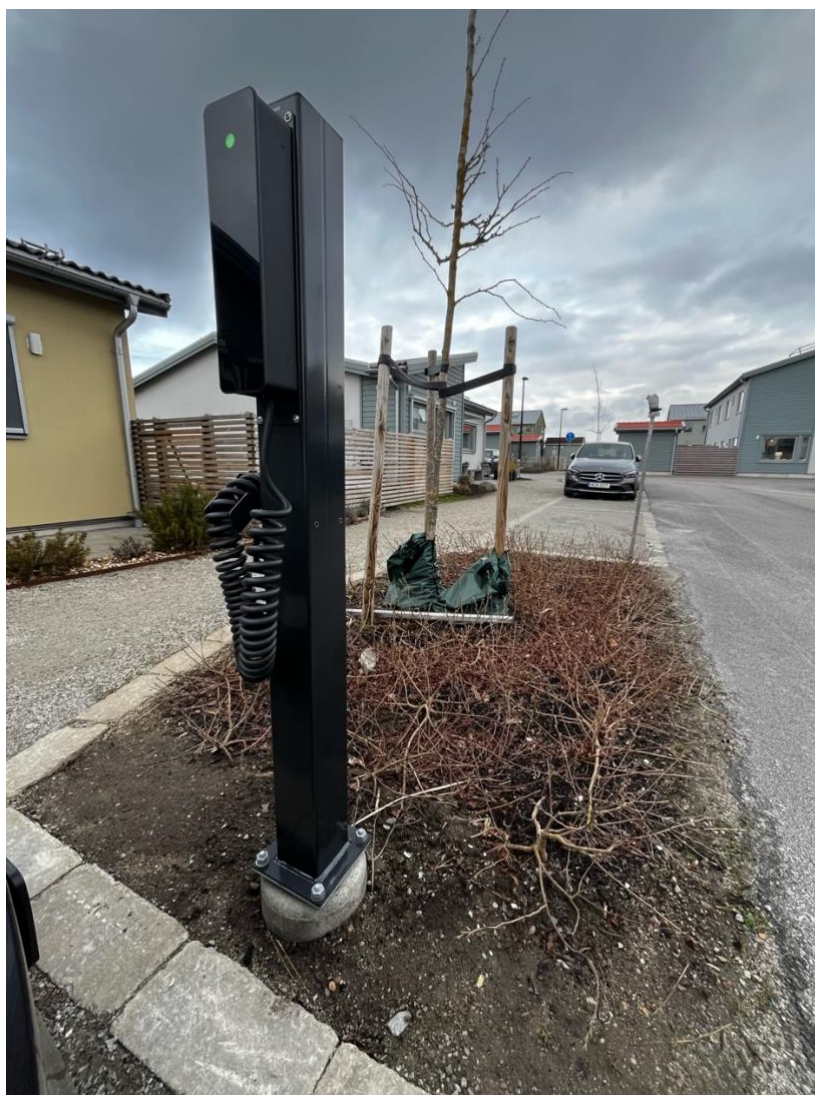
Figur 5 Foto av den installerade laddningsstolpen framför respektive parkeringsplats, notera att kablar har installerats under marken från husets ingång och under gångvägen
